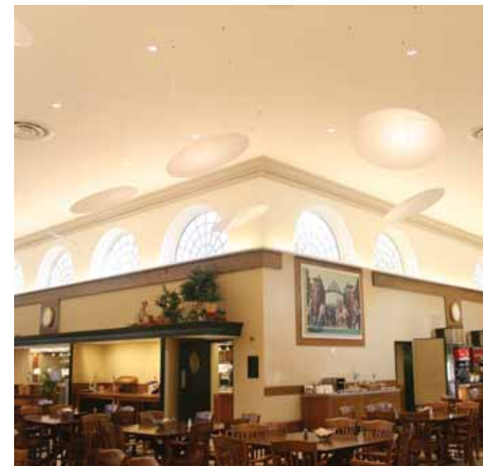
Bronwn University, Rhode Island, Dining Facility / Sonaspray FCX-TR, снежно-белый, 12 мм / 920 кв. м
