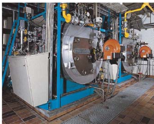
Виброизоляция теплового котла
